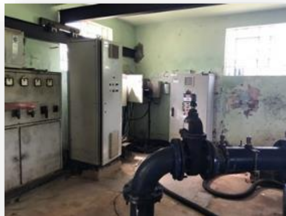
Figura 66 - Painéis elétricos da casa de bombas.
