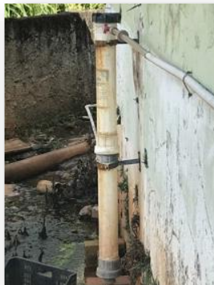
Figura 54 - Dosador de produtos químicos.
