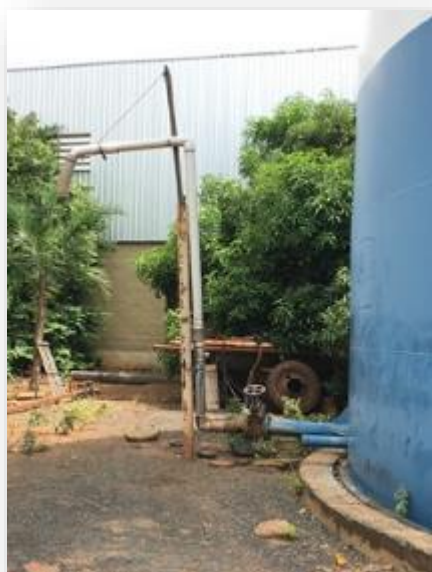
Figura 163 - Instalação para carregar caminhão pipa.
