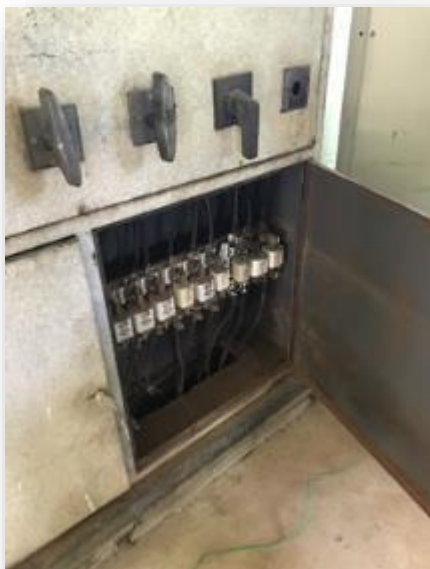
Figura 68 - Painéis elétricos da casa de bombas.
