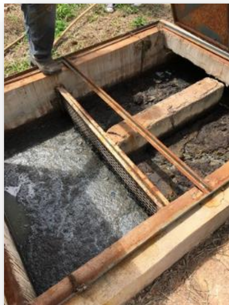
Figura 192 - Entrada de esgoto na EEE Verona.
