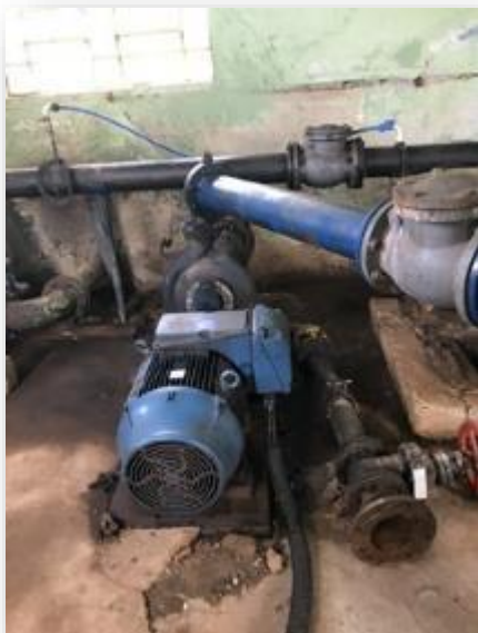
Figura 64 - Bomba para Distrito Industrial (via Casa Branca)
