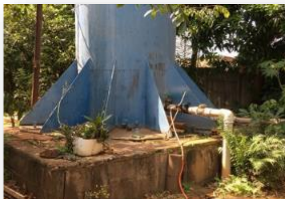
Figura 146 - Tubulações do reservatório R09.
