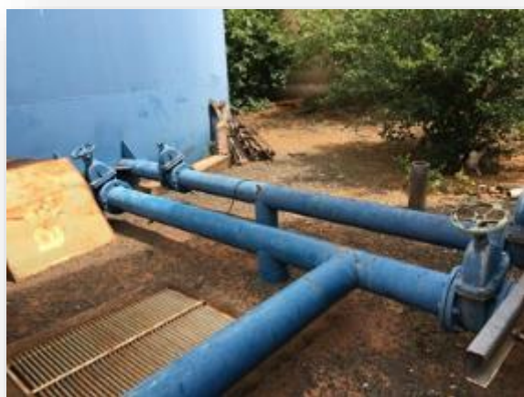
Figura 160 - Tubulações que interligam os reservatórios.
