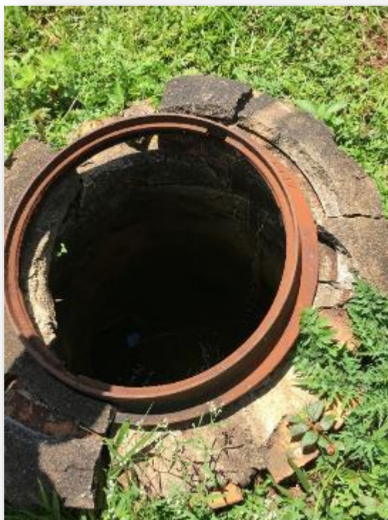
Figura 231 - PV de Saída da Lagoa de maturação.
