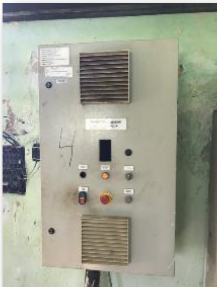
Figura 69 - Painéis elétricos da casa de bombas.
