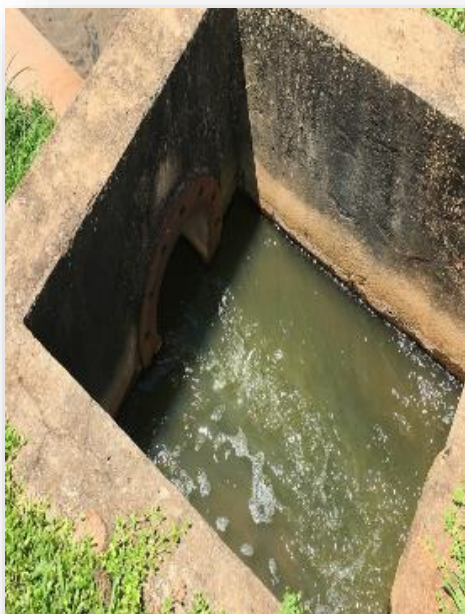
Figura 228 - Saída da Lagoa de maturação.
