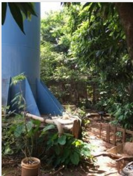
Figura 147 - Vista geral com tubulações
