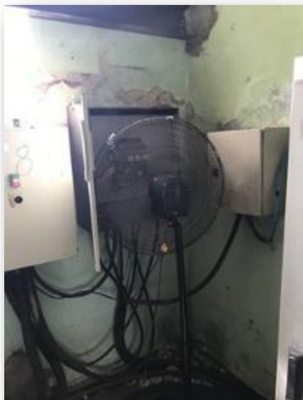
Figura 72 - Painéis elétricos da casa de bombas
