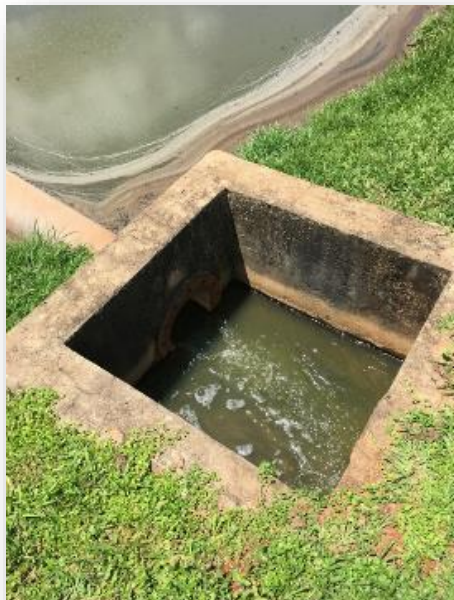
Figura 227 - Saída da Lagoa de maturação.
