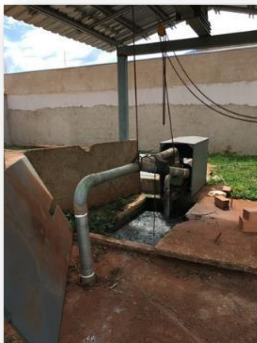
Figura 193 - Poço de sucção EEE Verona.
