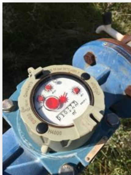
Figura 104 - Medidor do poço.
