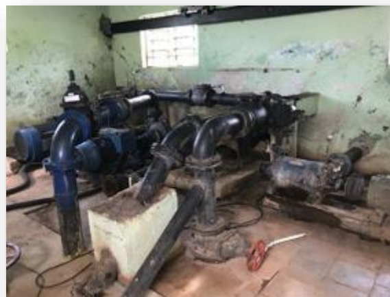
Figura 62 - Bombas de recalque.
