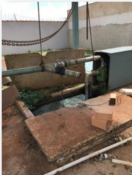
Figura 194 - Poço de sucção EEE Verona.
