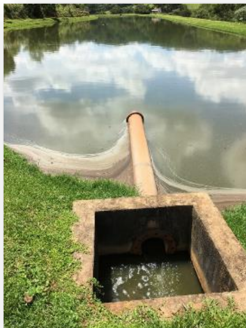
Figura 229 - Saída da Lagoa de maturação.
