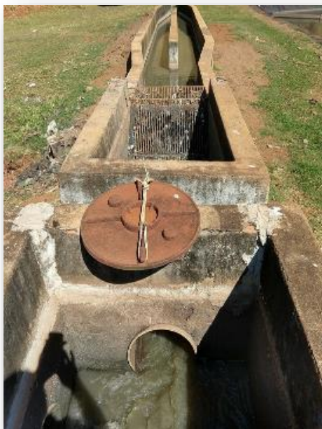
Figura 211 - Canal de chegada com pretratamento.
