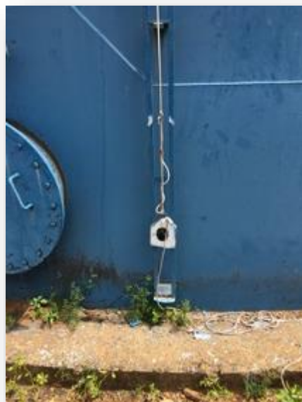
Figura 161 - Medidor de nível.
