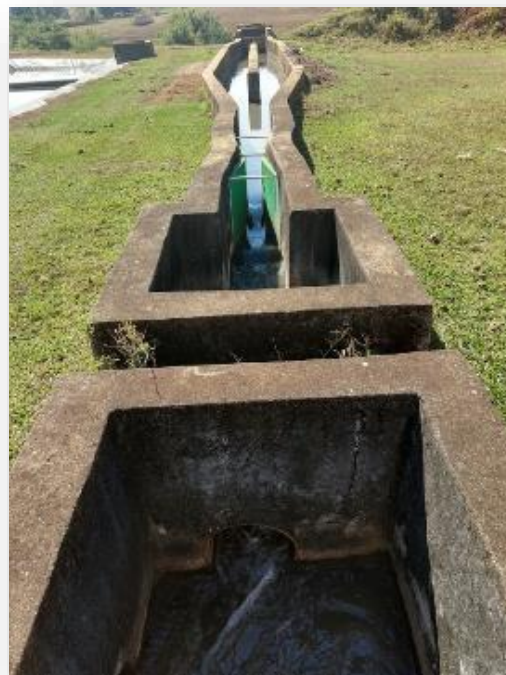
Figura 218 - Tratamento Preliminar desde Caixa Saída
