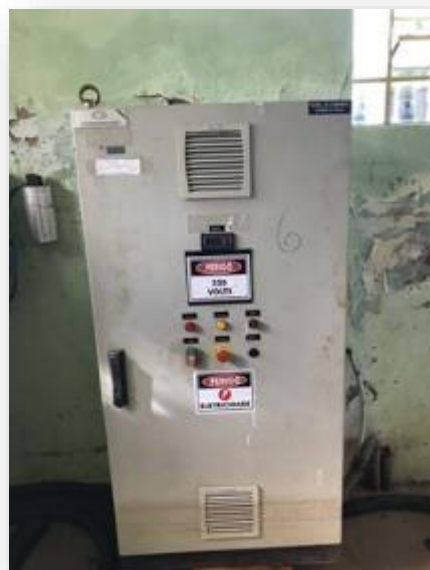
Figura 71 - Painéis elétricos da casa de bombas.
