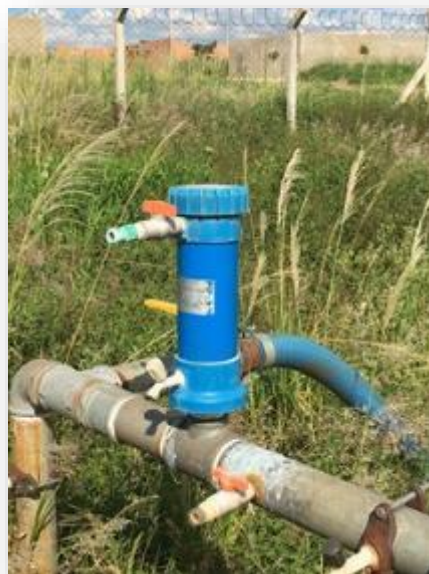
Figura 105 - Dosador de produtos químicos
