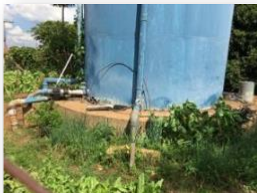
Figura 129 - Tubulações na frente.
