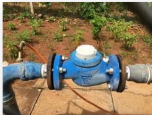
Figura 84 - Macromedidor do Poço COHAB II.
