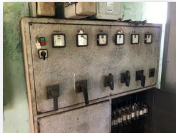
Figura 70 - Painéis elétricos da casa de bombas.
