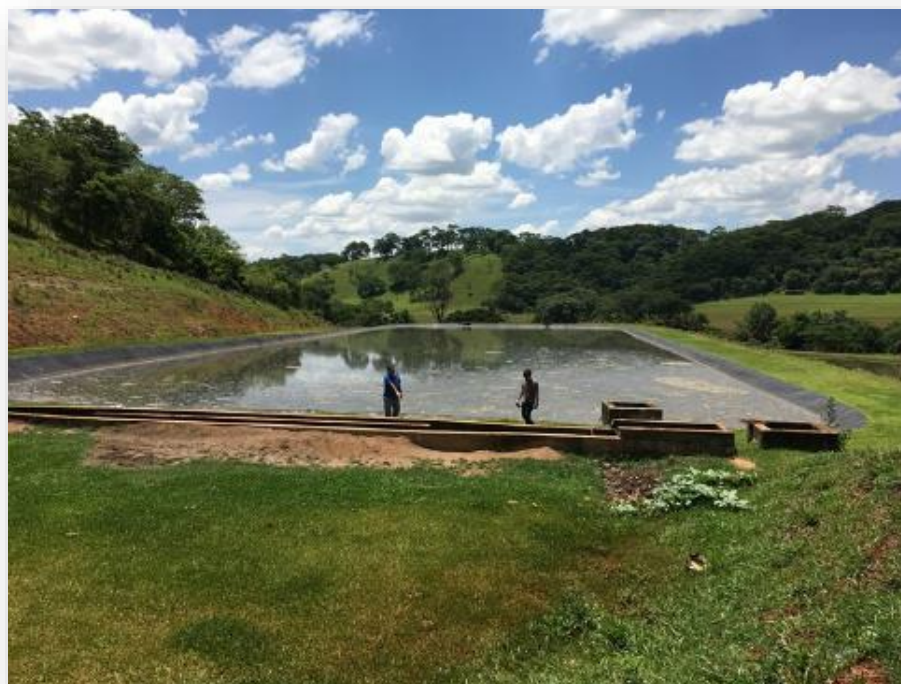
Figura 210 - Lagoa anaeróbia com tratamento preliminar na frente.
