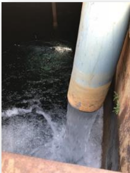
Figura 60 - Poço de sucção com bombeio do poço.
