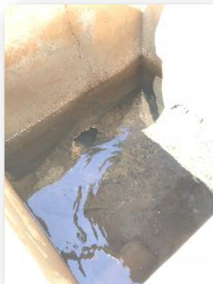
Figura 59 - Poço de sucção no Reservatório 01.
