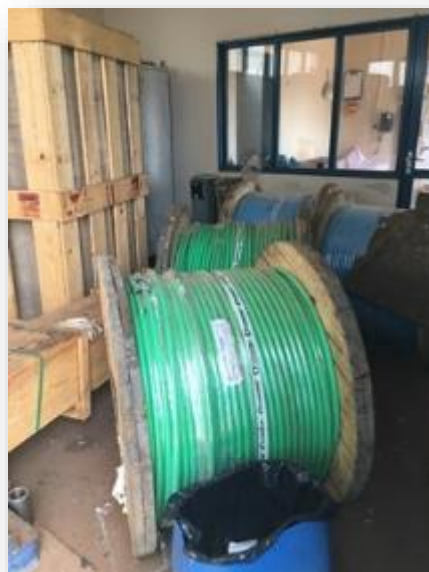
Figura 94 - Fiações para o poço.
