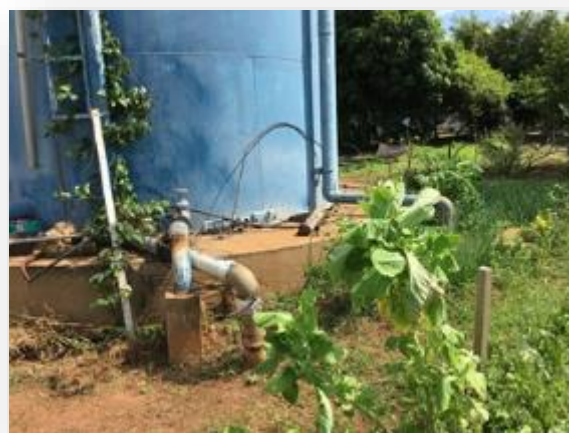
Figura 128 - Tubulações na frente.
