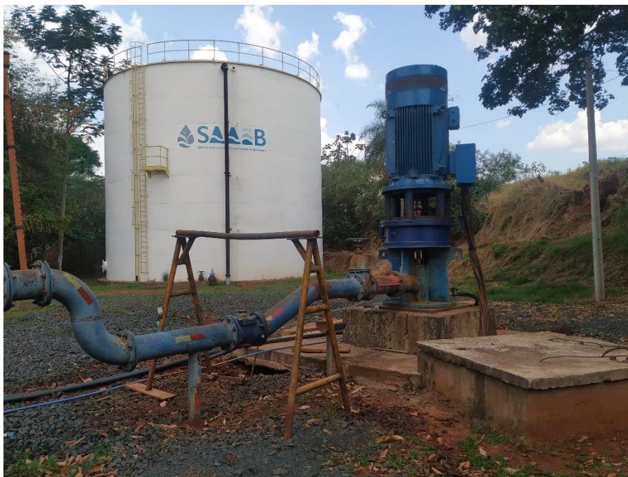
Foto 1: Vista da bomba que explora do poço Contendas III e do reservatório apoiado no CPR Contendas
