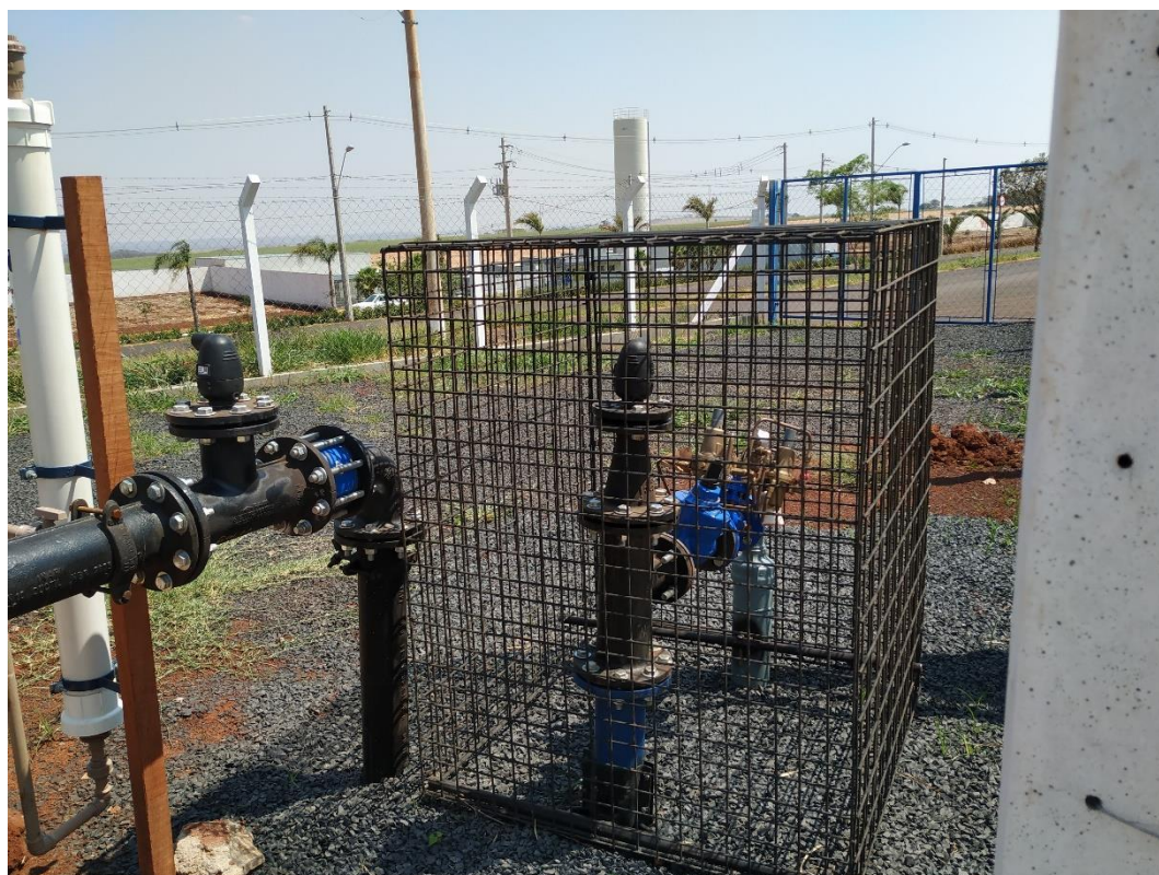
Foto 16: Golpe de aríete instalado junto ao poço Jardim Miranda
