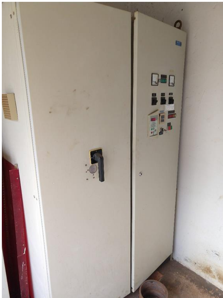
Foto 10: Vista do painel de comando e energização do poço Casa Branca
