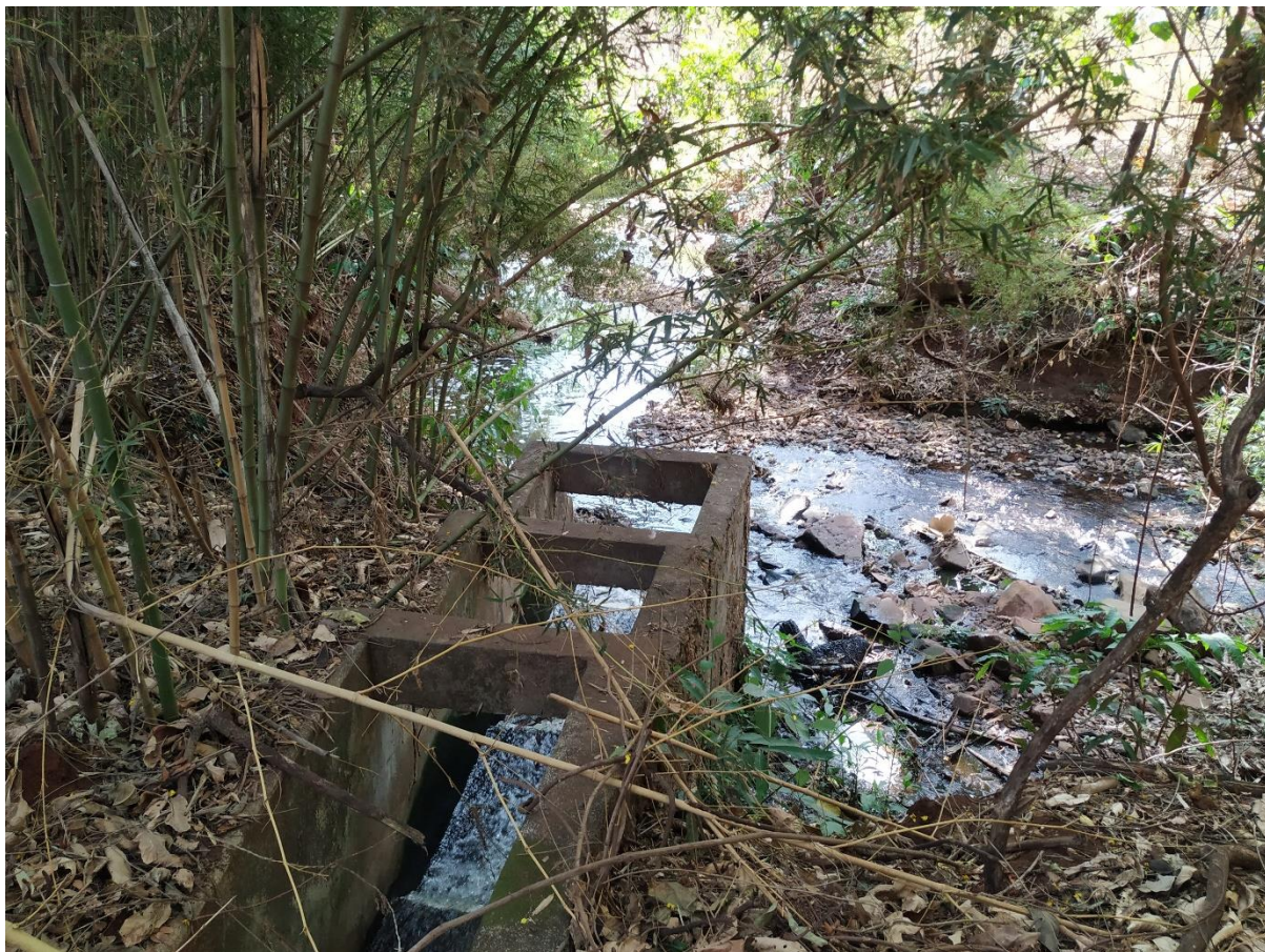
Foto 44: Ponto de lançamento da ETE Divisa
