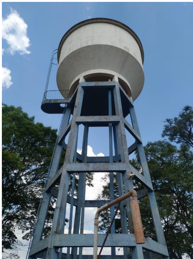
Foto 8: Reservatório elevado no CPR Casa Branca
