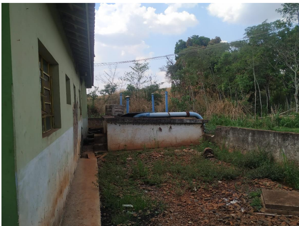
Foto 2: Vista do reservatório atualmente alimentado pelo poço e que serve como poço de sucção para os conjuntos motobomba
