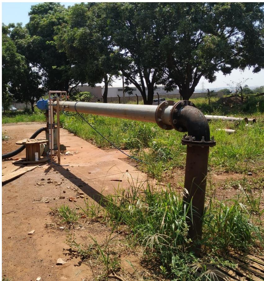
Foto 11: Poço Distrito Industrial
