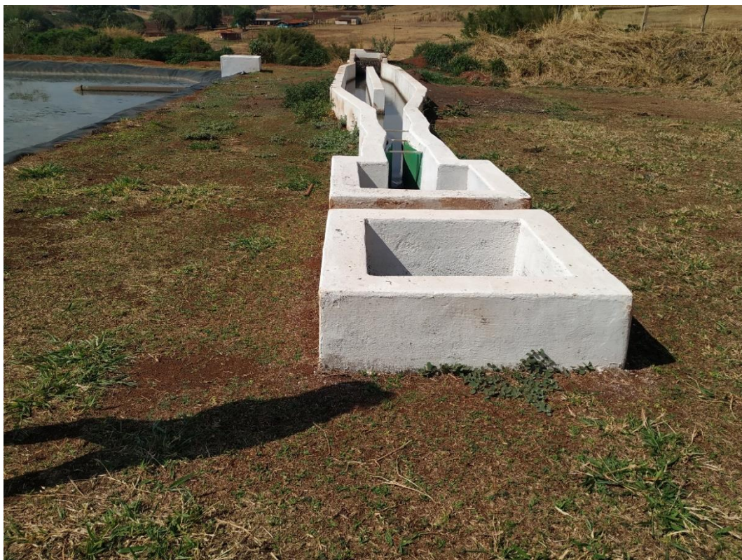
Foto 38: Vista da calha Parshall na ETE Divisa
